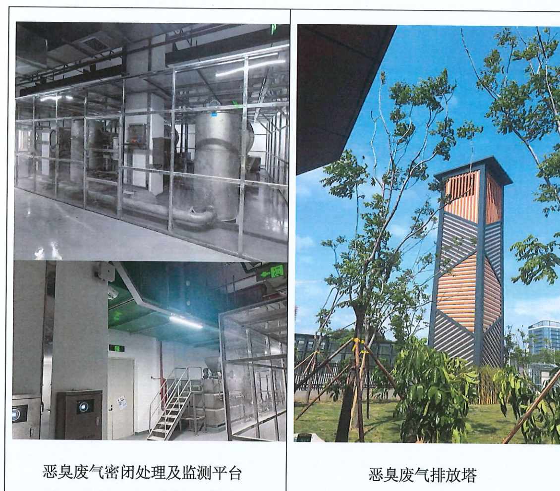
图4.1-4恶臭废气处理设施
