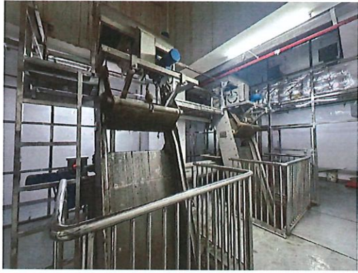
粗格栅及进水泵房
