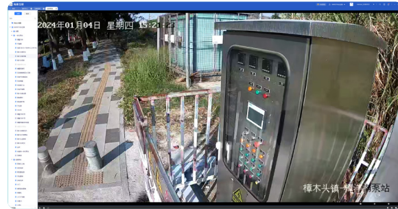
管网公司樟洋南泵站无人值守模式
