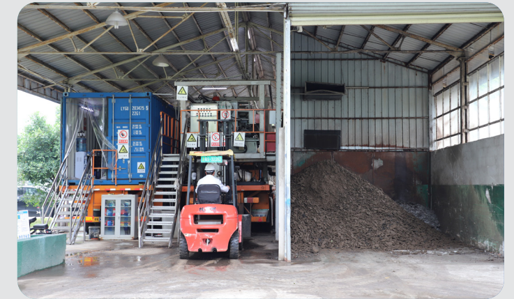
污泥脱水减量自运营项目
