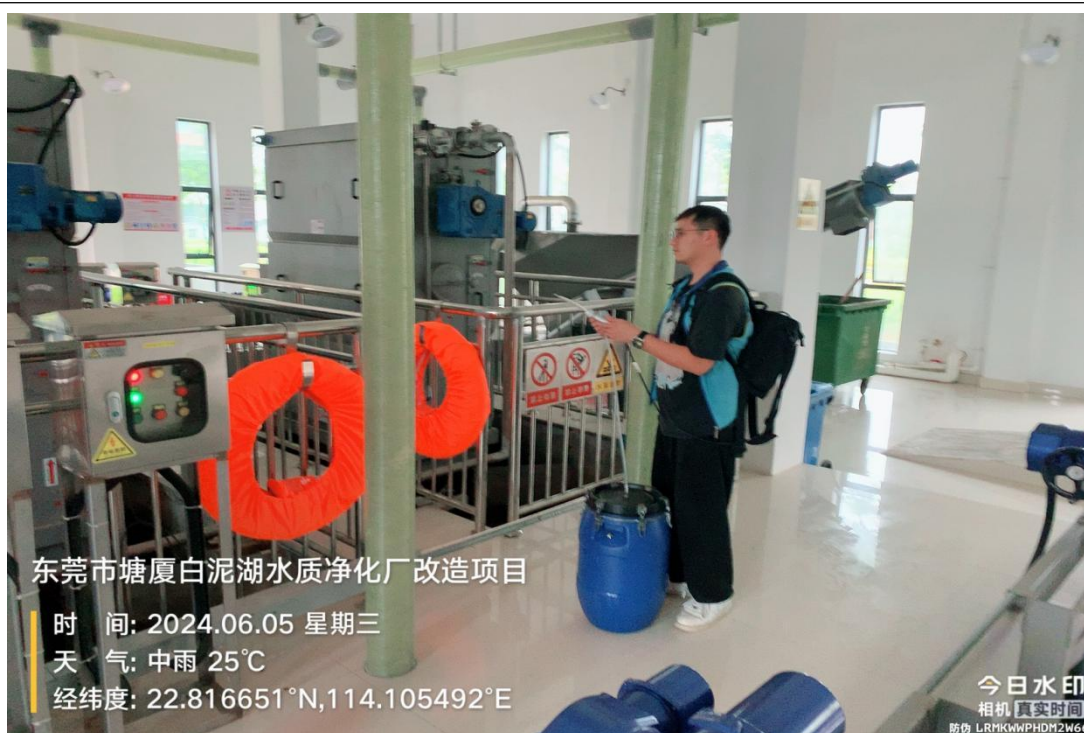
厂区浓度最高点（粗格栅及进水泵房）
