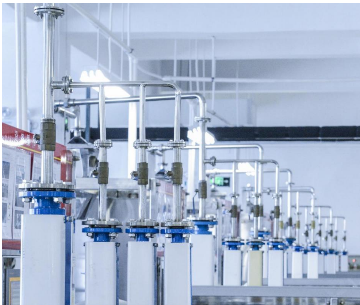
水表智能化检定车间
