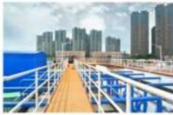
南村污水一体化水质净化设备项目一期
