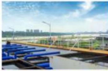
南村污水一体化水质净化设备项目二期
