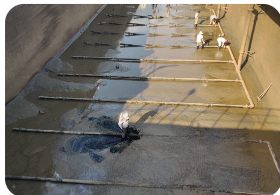
曝气系统更换前
