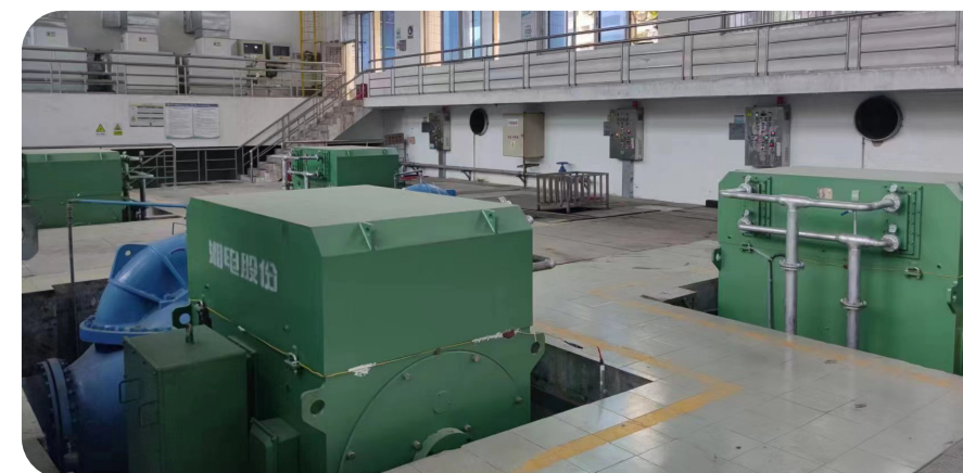
第三水厂改造后的水泵
