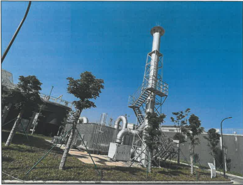
图 4.1-11 恶臭废气 2#处理设施
