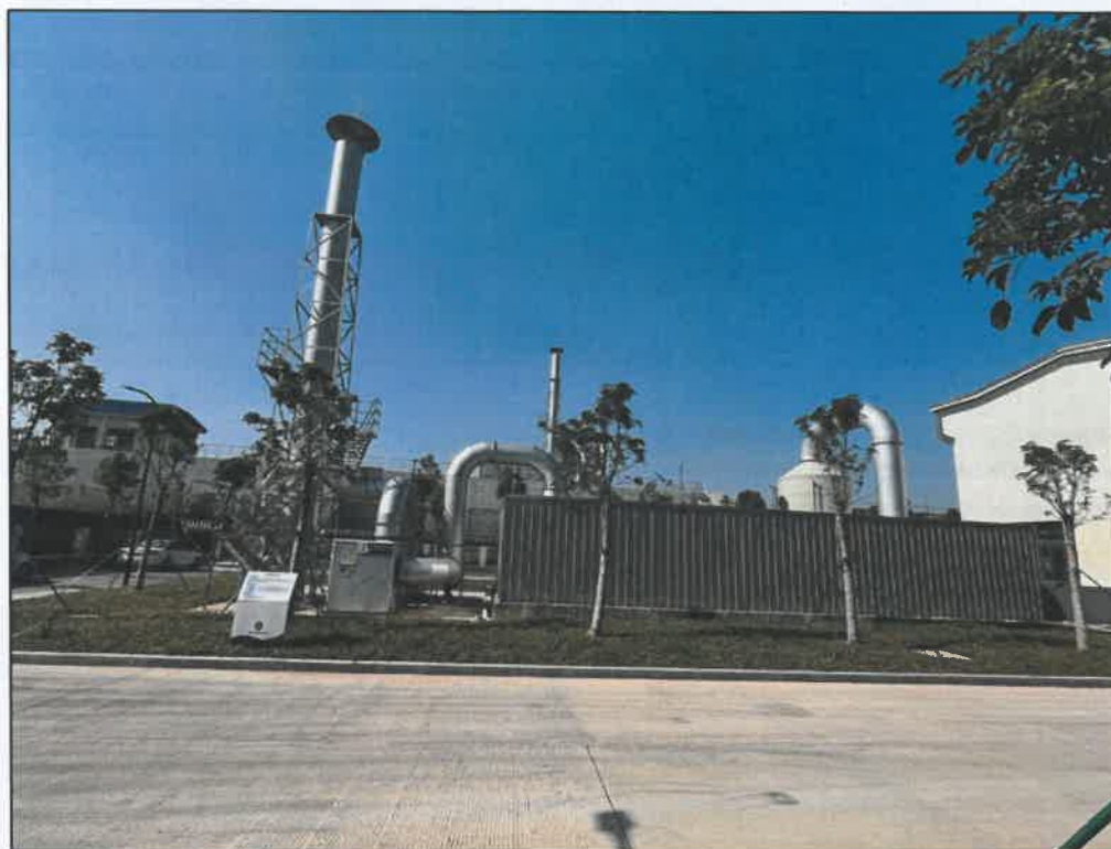
图 4.1-10 恶臭废气 1#处理设施
