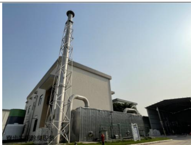
现有排气筒及处理措施
