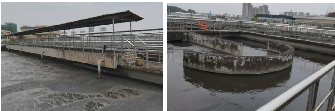
图2.3-12 茶山镇污水处理厂一期 A-A 2 /O 生化池现状图
