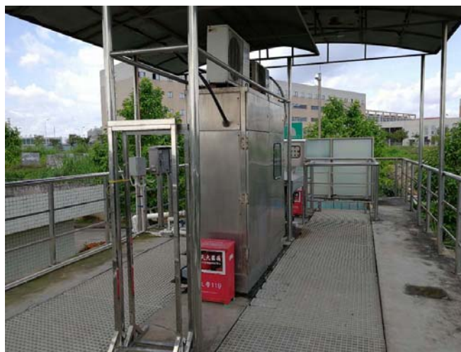
图2.3-14 茶山镇污水处理厂一期紫外消毒渠现状图
