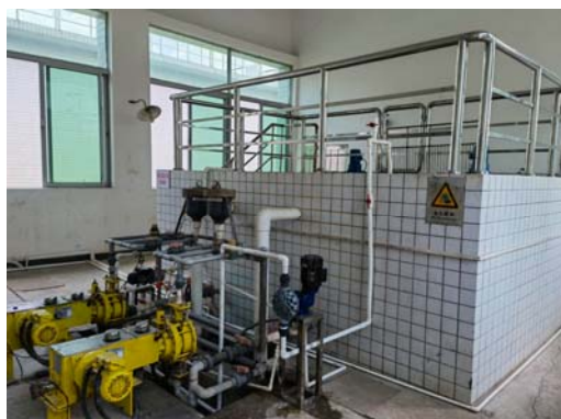
图2.3-18 茶山镇污水处理厂一期加药间现状图
