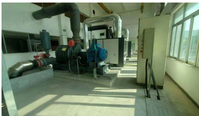
图2.3-15 茶山镇污水处理厂一期鼓风机房现状图
