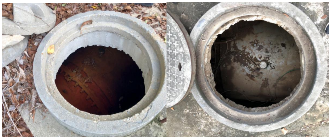
图 3.7-6 二期进出水流量计均已损坏
