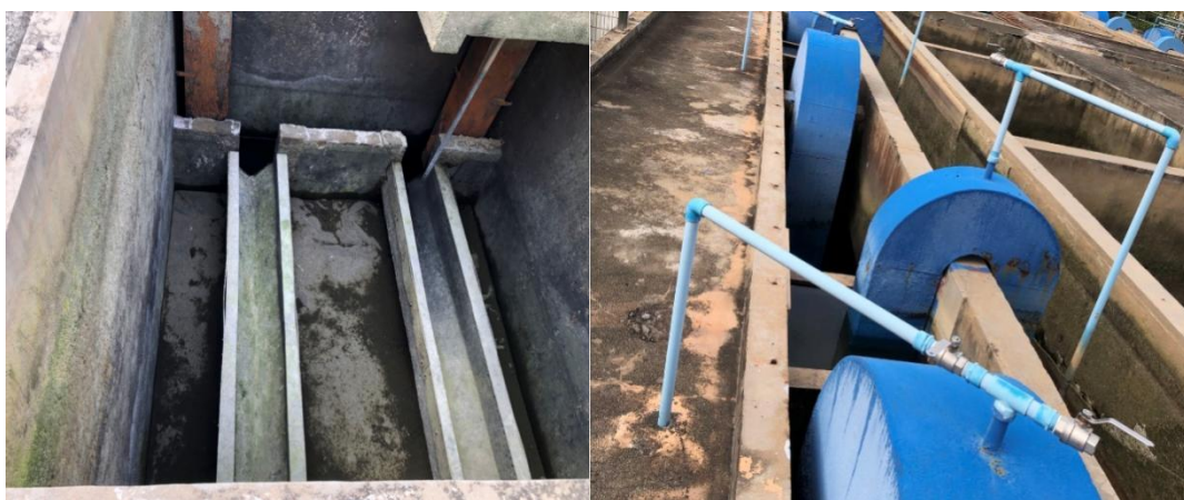
图 3.7-3 一期虹吸滤池
