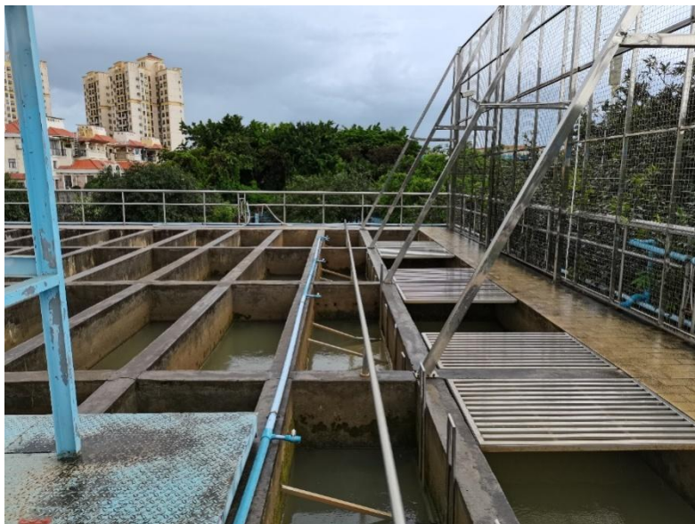
图 4.7-2 二期网格絮凝池
