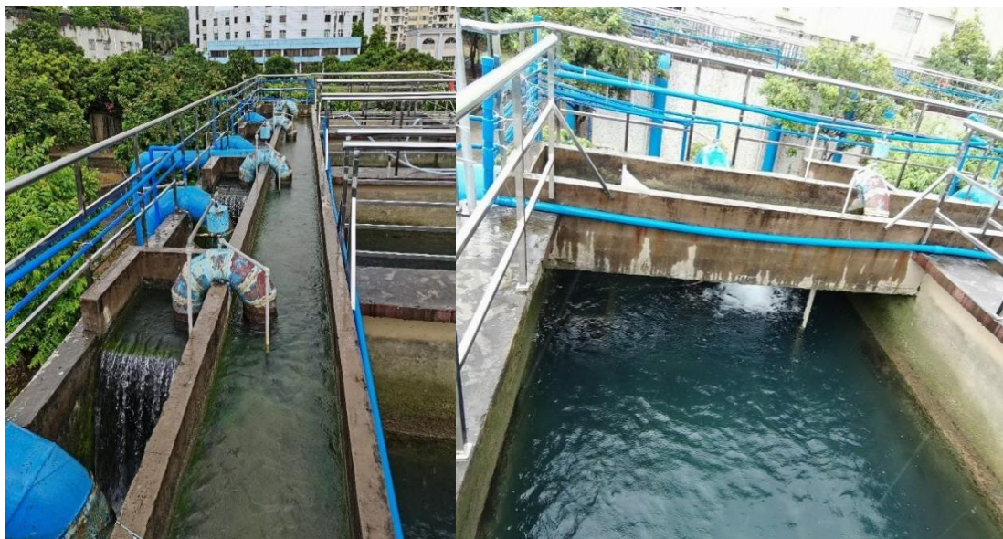
图 4.7-3 一期虹吸滤池现场照片
