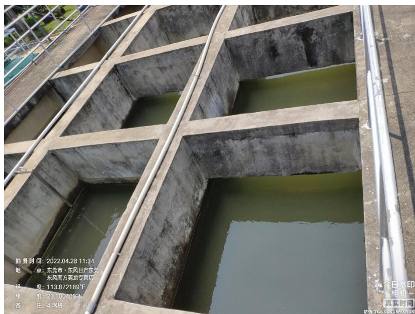
图 3.5-2 西湖水厂网格絮凝池
