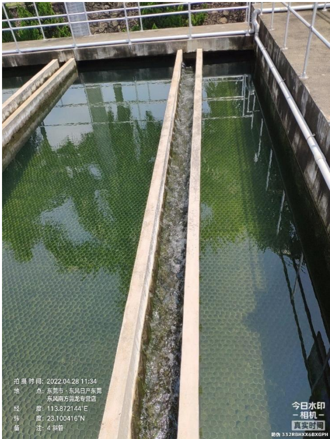
图 3.5-3 西湖水厂斜管沉淀池
