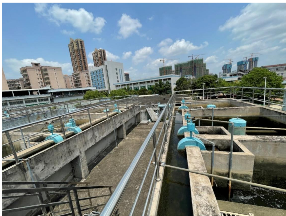
图 3.3-4 石碣水厂虹吸滤池
