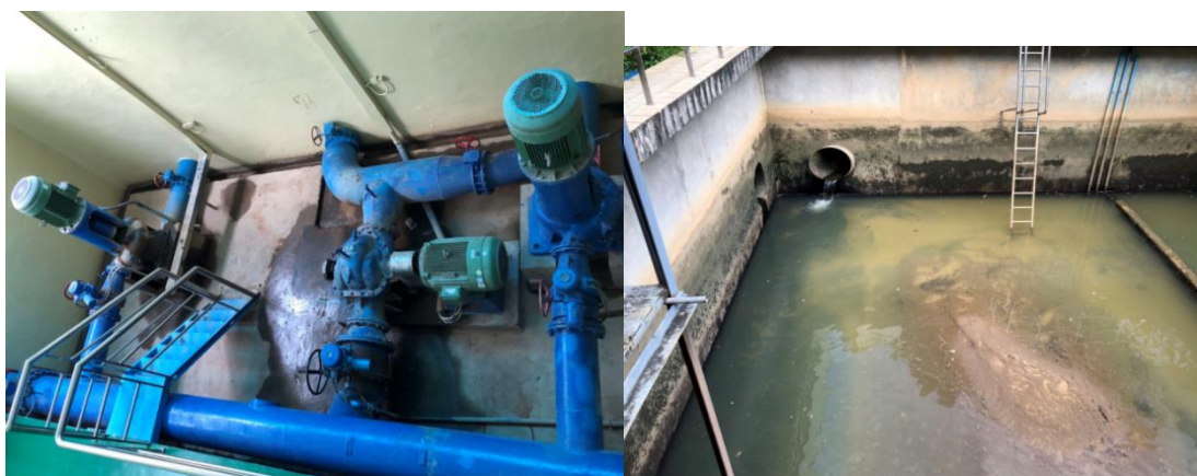
图 3.7-7 回用水系统提升泵房及集水池
