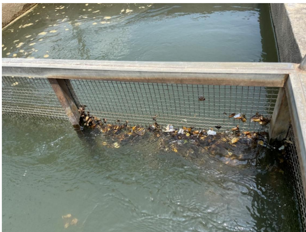
图 3.3-2 石碣水厂网格絮凝池
