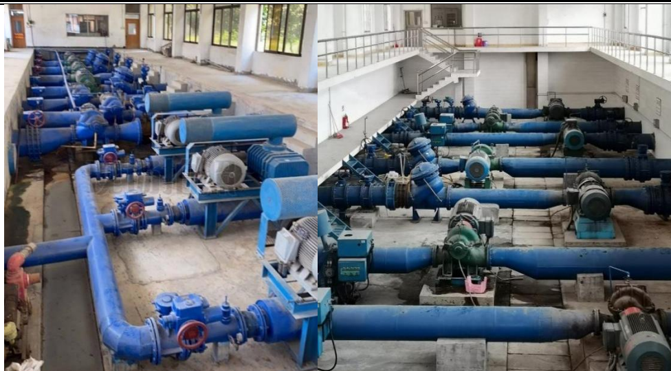
图 4.7-1 一期、二期二级泵房
